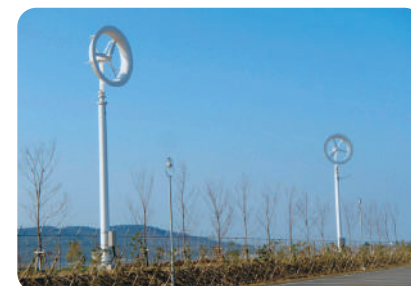
発電能力：5kW×2基
