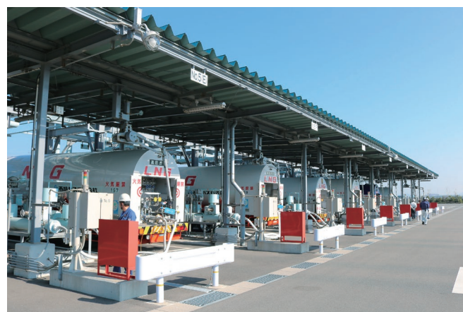
出荷設備（12レーン）
